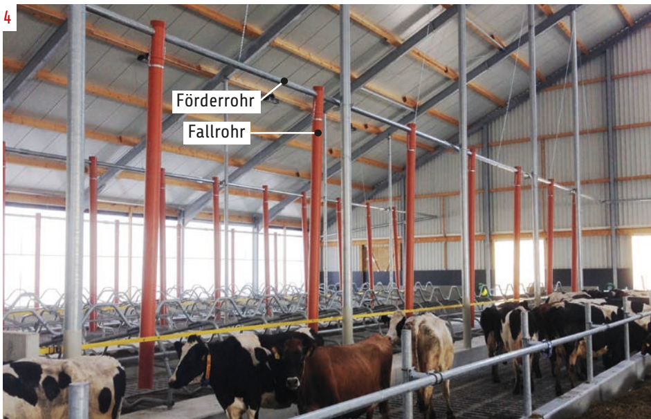
4 Förder- und Fallrohre im Rinderstall
