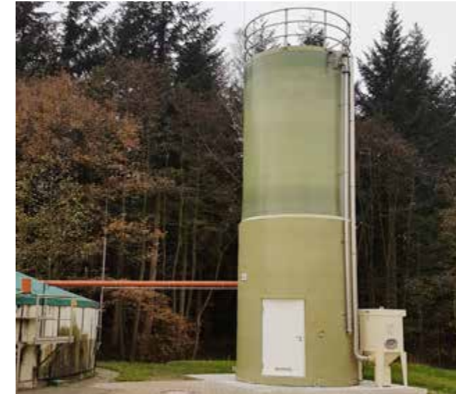
Gesamtansicht des Flüssigdosiersystems
