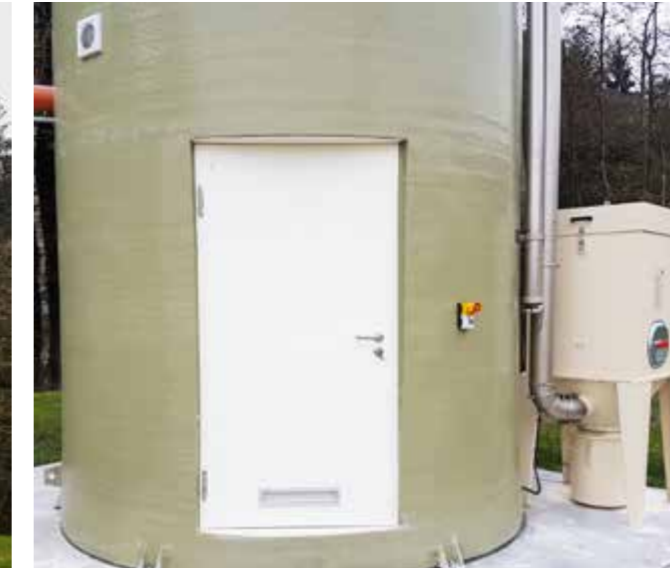
GFK- Silo mit isolierter Standzarge, Abluftfilter
