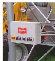
Opcjonalnie: szafa sterownicza na 5 przenośników ślimakowych
